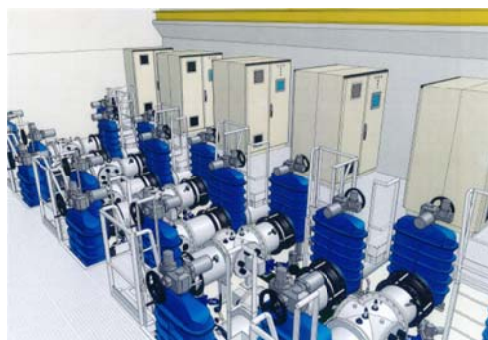
Les réacteurs UV de la future usine de traitement du Loing (vue en 3D) - mise en service en 2017
