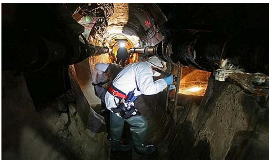
Canalisations parisiennes visitables ©Targat
