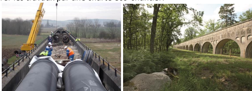
Chantier de remplacement de conduites, siphon de l'Yonne, aqueduc de la Vanne (89) ©EaudeParis - Aqueduc de la Vanne ©Targat
