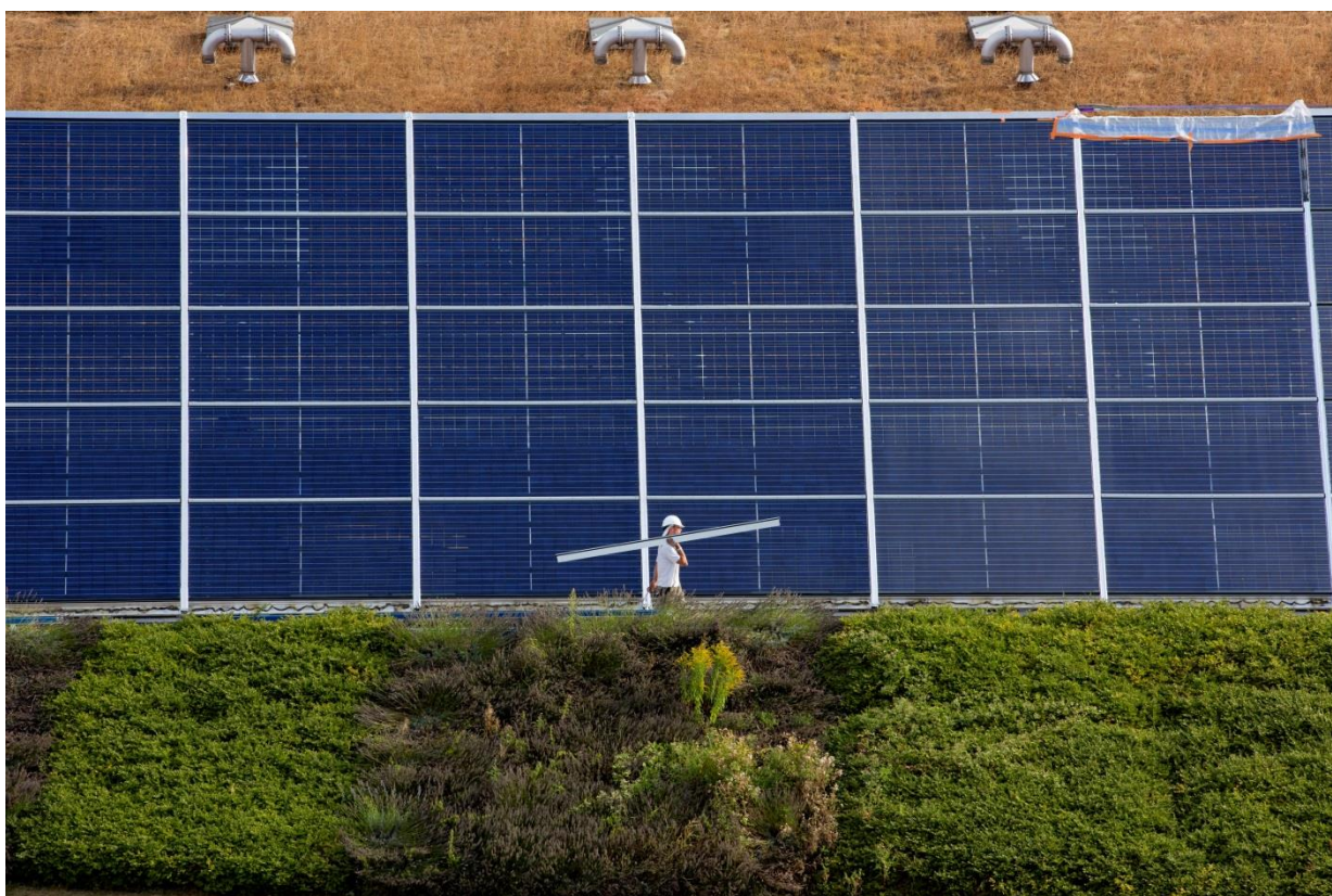
Panneaux photovoltaïques à l'usine d'Orly ©EaudeParis
