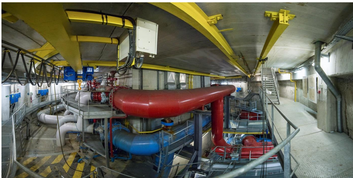
Usine d'eau non potable d'Austerlitz ©EauDeParis
