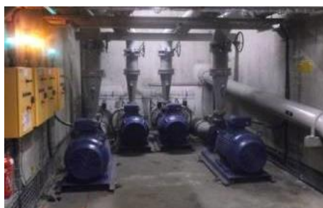
Pompes d'eau pressurisée, Usine de Joinville ©EaudeParis
